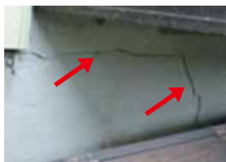
基礎のひび割れ
