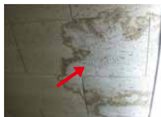
外部及び内部の雨染み
