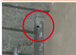
シーリング材の割れ、施工不備
